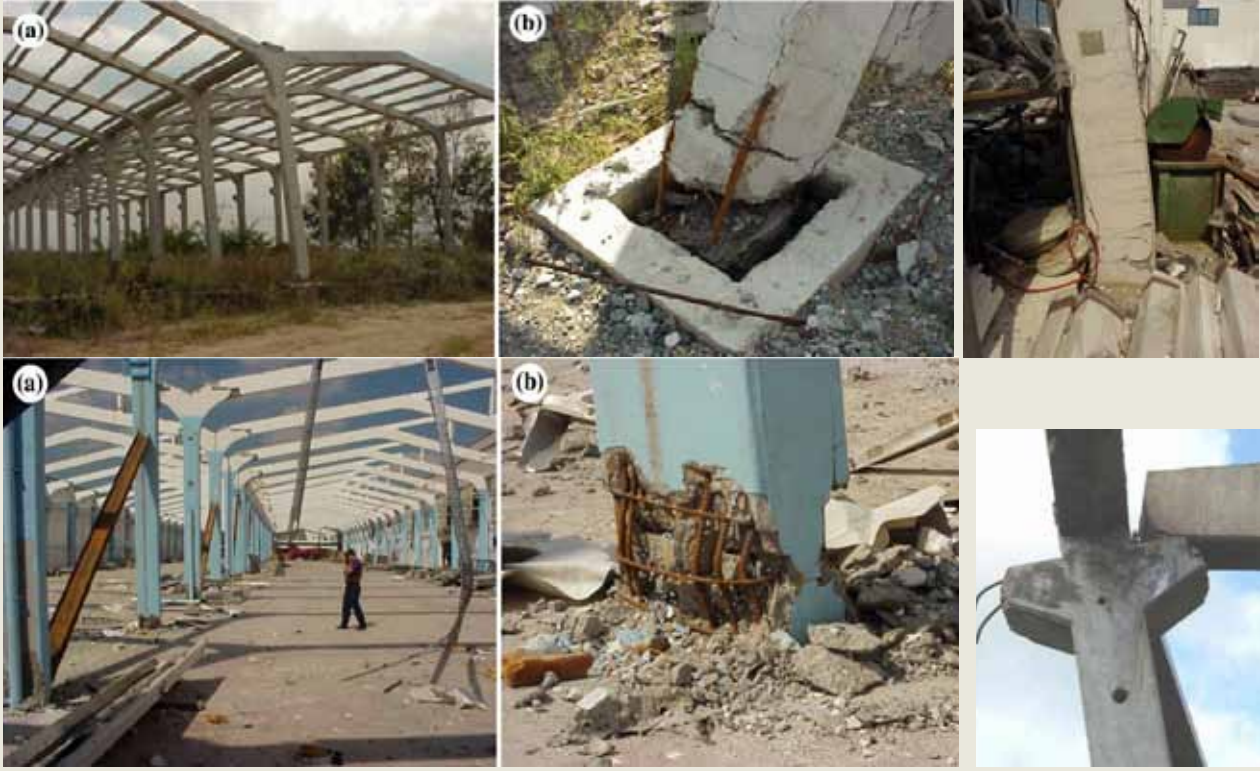
Şekil 1: Prefabrik binalarda meydana gelen tipik deprem hasarlarından örnekler
